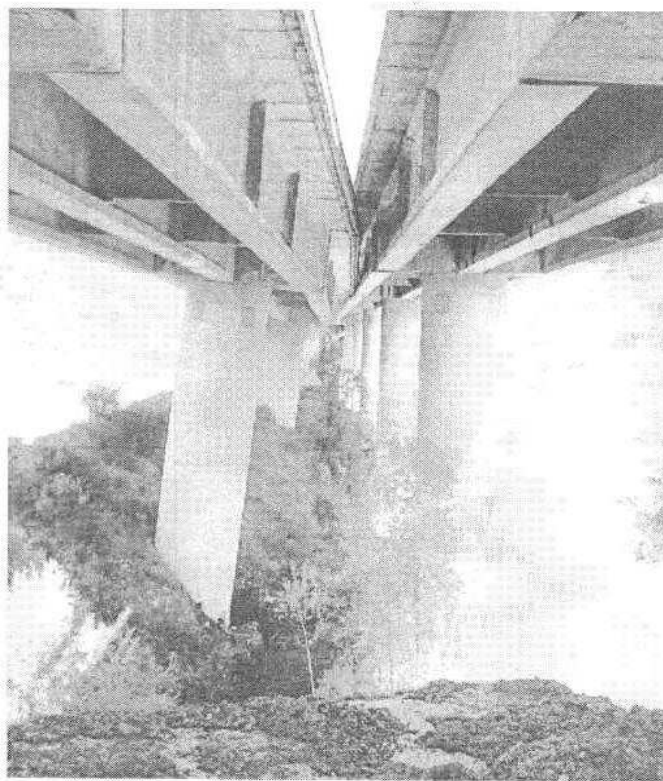
Il viadotto Himera che per un cedimento sta spezzando la Sicilia in due
